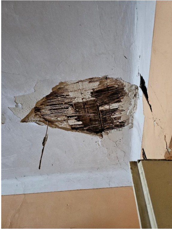
Fotografia 25 Ubytek w stropie nad parterem.
