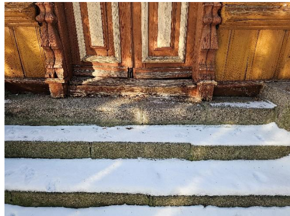
Fotografia 14 Schody zewnętrzne z niszcującym, drewnianym progiem drzwi zewnętrznych
