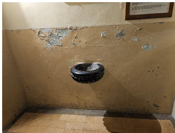
Fotografia 4 Odparzenia, uszkodzenia, łuszczenie tynku na ścianach w przestrzeni kruchty.
