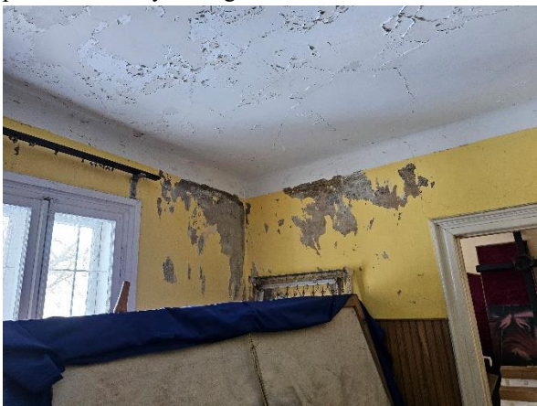
Fotografia 23 Niszczące wykończenie ścian, odspojenia, łuszczenie tynku.
